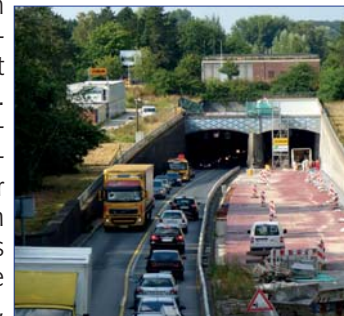
Die Grundsanierung des Autotunnels bei Rendsburg schleppt sich dahin – Fertigstellung angeblich 2020. Unmöglich, sagt die Wirtschaft
