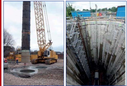
In Holtenau wurden bereits die Mitteldüker auf den neuesten technischen Stand gebracht - das sind Schächte für die Versorgungsleitungen der Schleusen.
