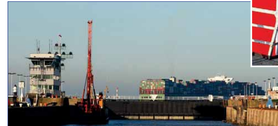
Vorerst geschlossen – so hieß es tageweise über viele Wochen in den Brunsbütteler Schleusenanlagen, Ursache waren marode Schleusenführungen der Schleusentore.
