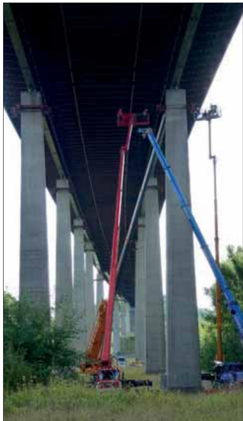
Poröse Brückenpfeiler an der Rader Hochbrücke über den Nord-Ostsee-Kanal verursachten 2013 ein Monate langes Verkehrs-Chaos in der gesamten Region – die Brücke wurde in der Presse schnell als Symbol für die marode Infrastruktur in der Bundesrepublik stilisiert.
